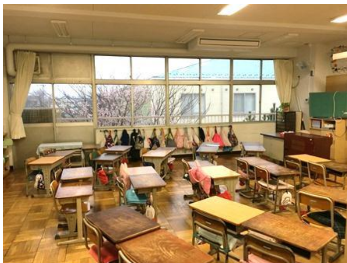
空調設備の設置状況（古山小学校）
