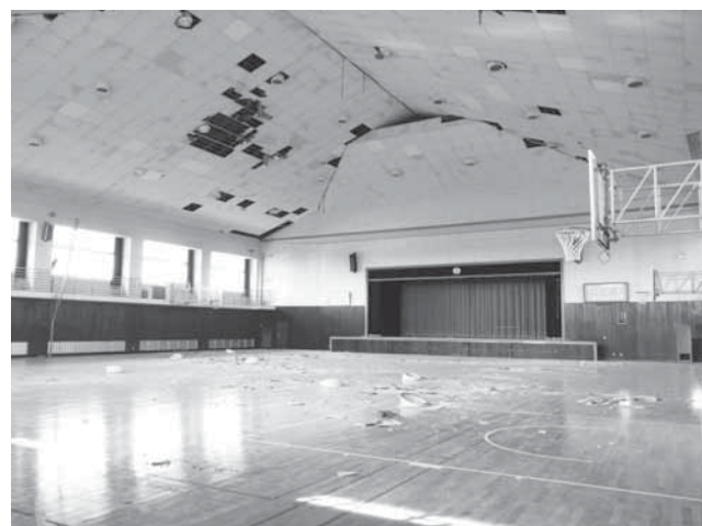
被害を受けた国分寺中学校体育館
