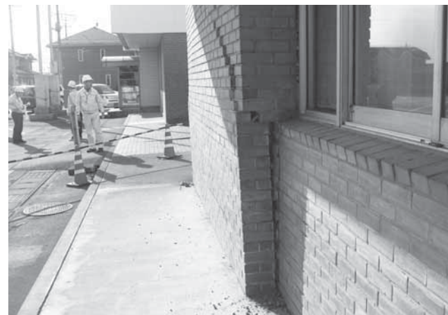
被害を受けた南河内庁舎
