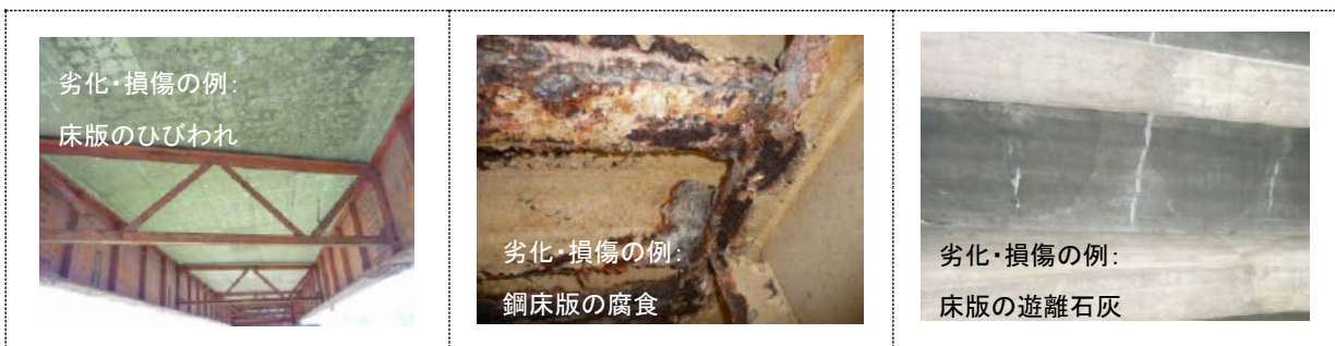
図 3-6 橋りょう（計 37 橋）の老朽化の状況（H21 年度点検結果より抜粋）
