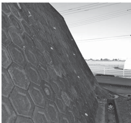
内部の空洞化が懸念される南河内中学校の擁壁
