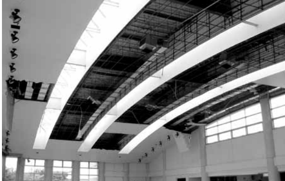
地震により天井がはがれ落ちたふれあい館屋内プール
