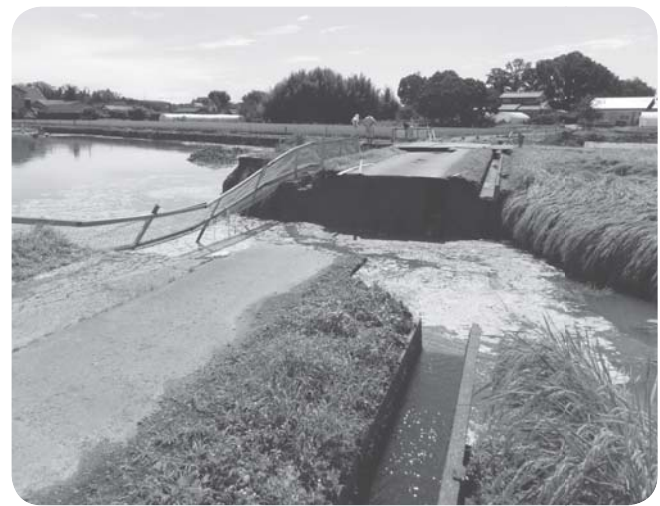
削り取られた道路
