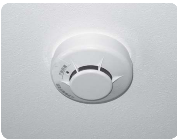
設置が義務化されている火災報知器
