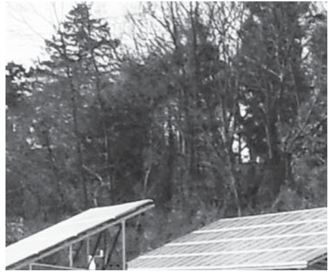
設置された太陽光発電設備
