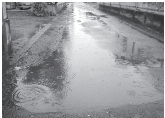
雨水対策のされていない通学路
