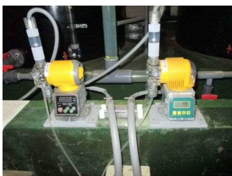
塩素注入装置
