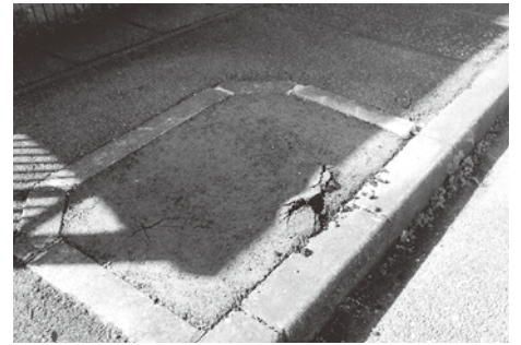
歩道の危険箇所
