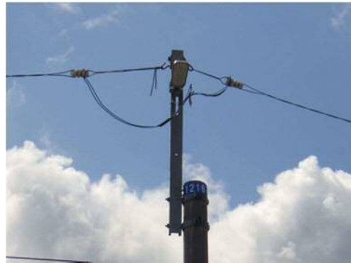
LED化された防犯灯
