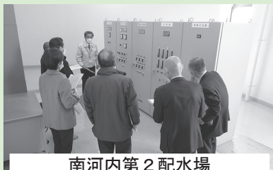
南河内第2配水場 機械電気設備更新事業
