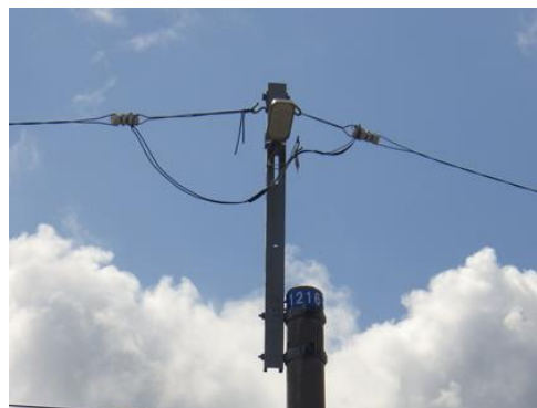
LED化された防犯灯
