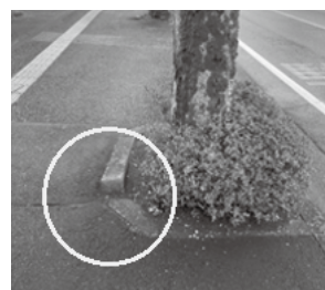
大きく盛り上がり 歩道もひび割れ
