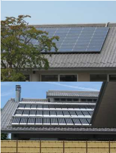
下野市保健福祉センター「ゆうゆう館」の太陽光発電・太陽熱温水器の活用
