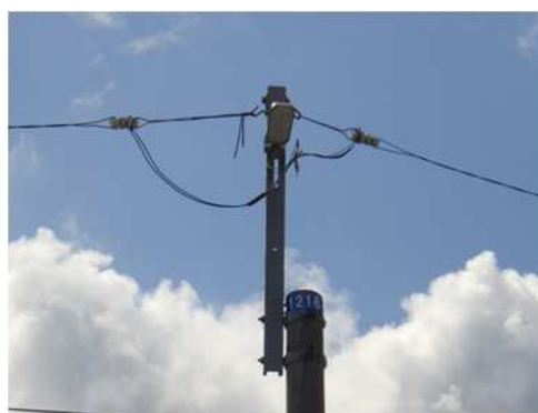
LED化された防犯灯
